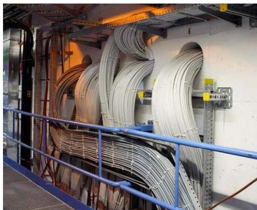
ATLAS Inner Det. Cables
