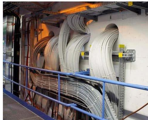
ATLAS Inner Det. Cables
