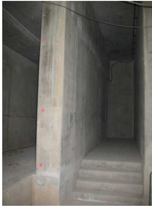
Zugang Labyrinth- Interlocktür X12 fehlt noch
