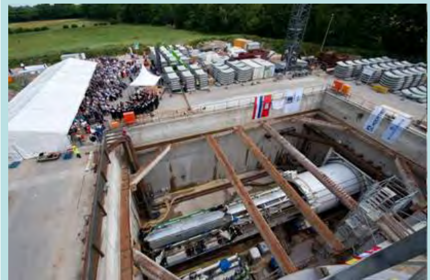
Schenefeld bei Hamburg, 30.6.2010: Erste Tunnel- und Bohrertaufe auf der European-XFEL-Baustelle Schenefeld am 30. Juni 2010. Im Vordergrund ist die Tunnelbohrmaschine im Startschacht zu sehen. (Foto: European XFEL)
